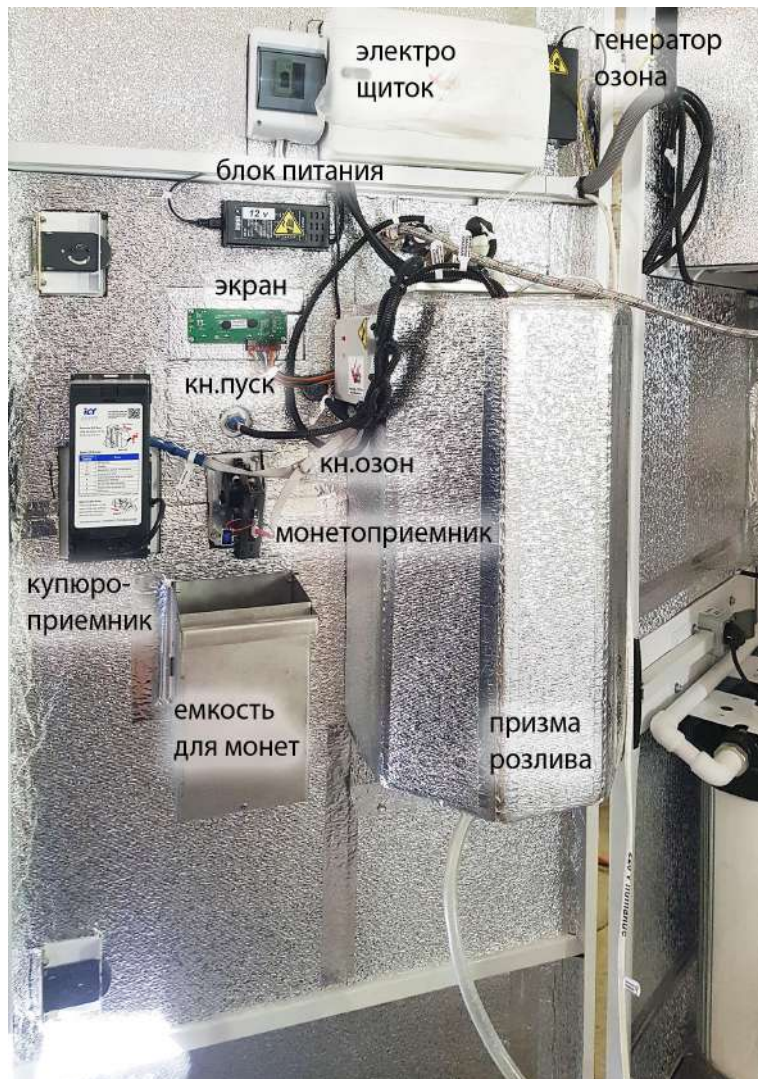
Рис 6. Дверца киоска с установленным оборудованием.
